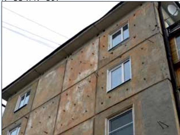
Отсутствие внешнего усиления и защиты панелей здания с неполным каркасом (ул. Дальневосточная, № 59)
